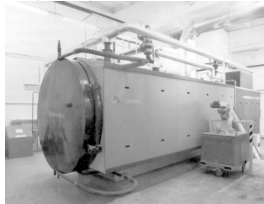
Kotelna na spalování dřevních odpadů v Netvořicích.
