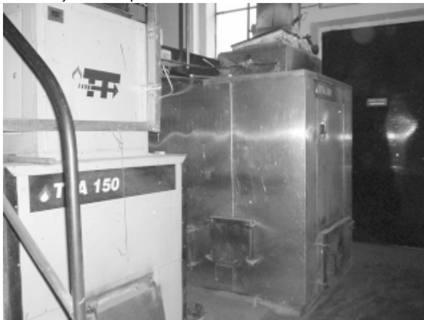
Interiér kotelny v Jinačovicích pod Smrkem.
